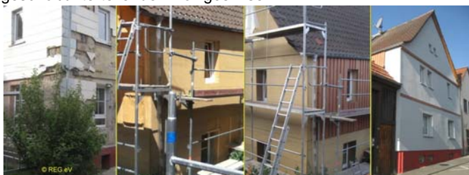
Baufortschritt v.l.: (1) Abriss der Eternit-Schindeln; (2) unterer Teil Rahmenhölzer mit eingepressten Holzflexmatten und oberer Teil bereits abgedeckt mit Holzfaserplatten; (3) rechts vorgehängte Holzfassade; (4) fertigverputzte Straßenansicht mit zwei Holzgesimsen
